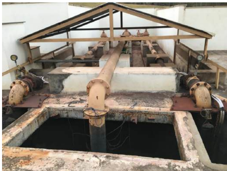
Foto 3.69 – Vista do poço de sucção da EEE Vila São Jorge
