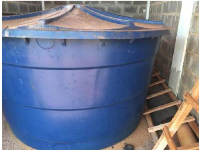
Foto 3.109 – Detalhe do abrigo do clorador para desinfecção do efluente
