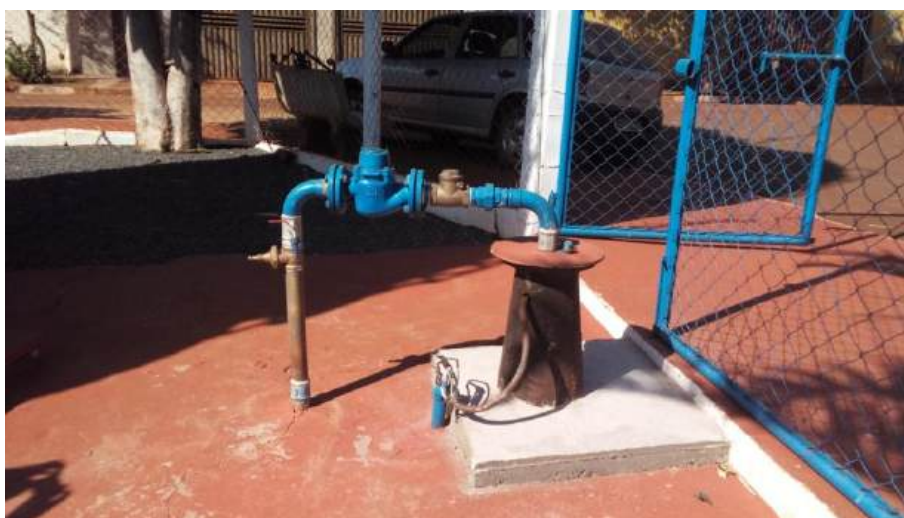
Foto 3.58 – Vista do poço do Distrito de Capivari da Mata
