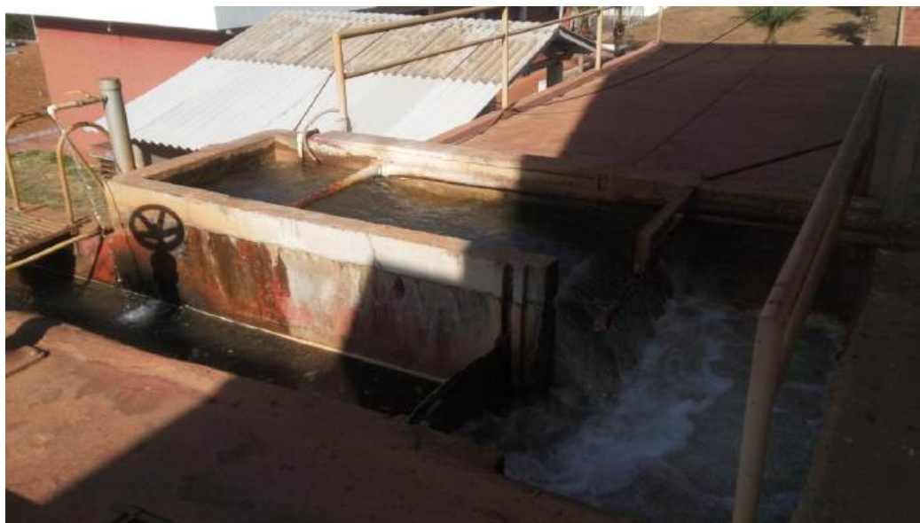
Foto 3.5 – Detalhe da chegada de água bruta na ETA e adição de produtos químicos
