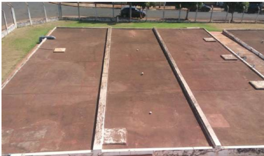
Foto 3.18 – Vista do Reservatório Enterrado 1 do Centro de Reserva Guanabara – 500 m 3
