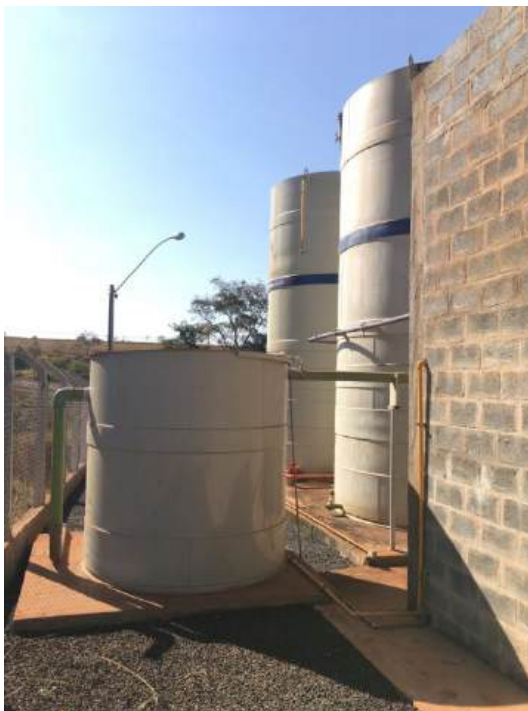
Foto 3.115 – Vista do tanque de recirculação de lodo
