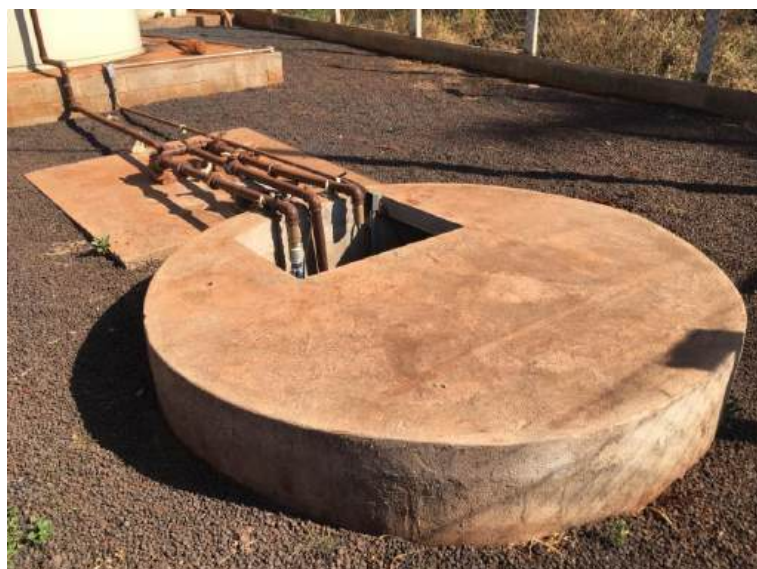
Foto 3.112 – Vista da estação elevatória no interior da ETE.
