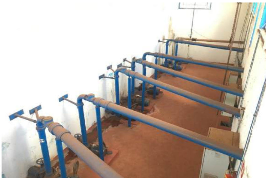
Foto 3.40 – Vista dos conjuntos motobomba da EEAT COHAB
