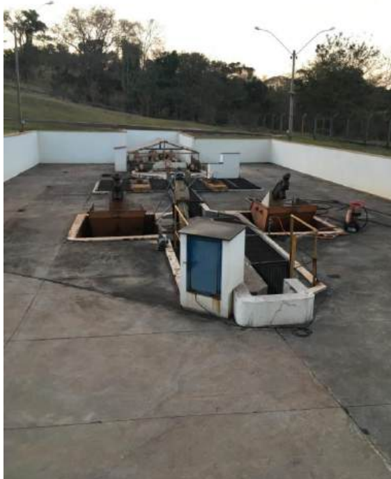
Foto 3.63 – Vista geral da EEE Vila São Jorge
