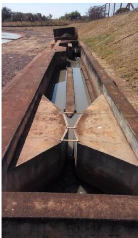
Foto 3.103– Gradeamento e Caixa de Areia, ETE de São Benedito da Cachoeirinha
