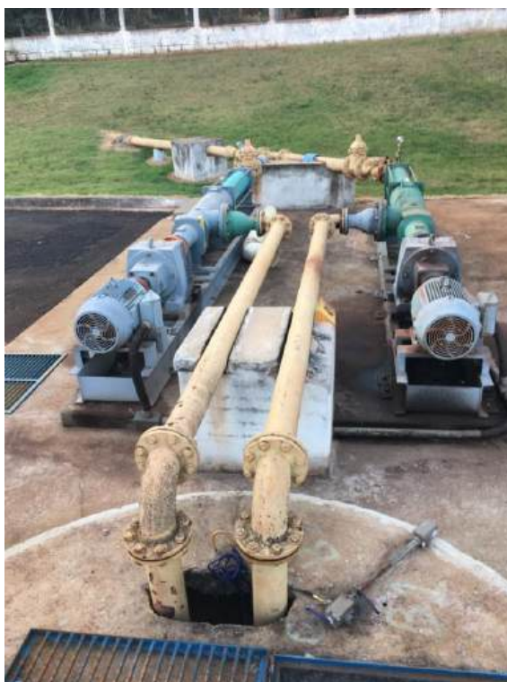
Foto 3.76 – Vista do sistema de bombeamento da EEE-2 Nosso Teto
