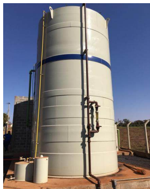
Foto 3.114 – Vista do reator da ETE de Capivari da Mata
