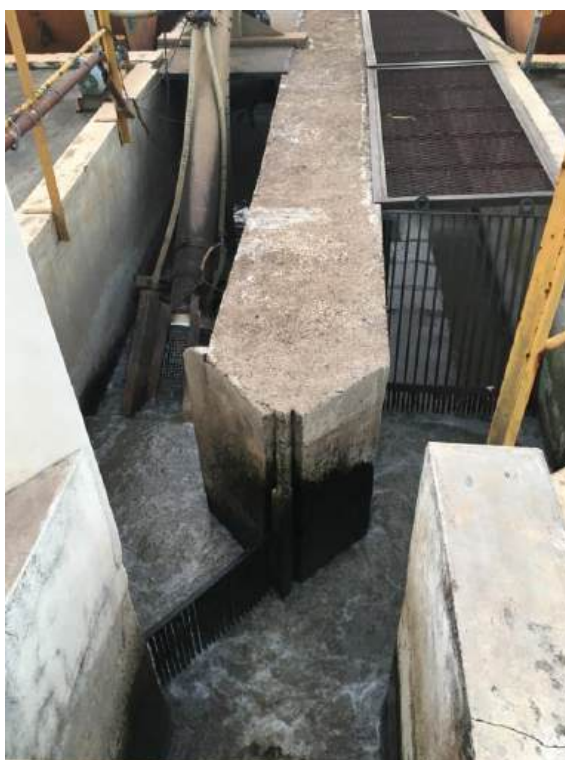
Foto 3.65 – Vista do gradeamento da EEE Vila São Jorge
