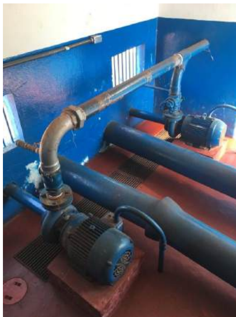
Foto 3.43 – Vista da EEAT localizada dentro da área do CR Tropical
