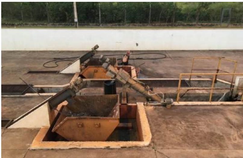
Foto 3.68 – Vista das caçambas de retirada de sólidos da EEE
