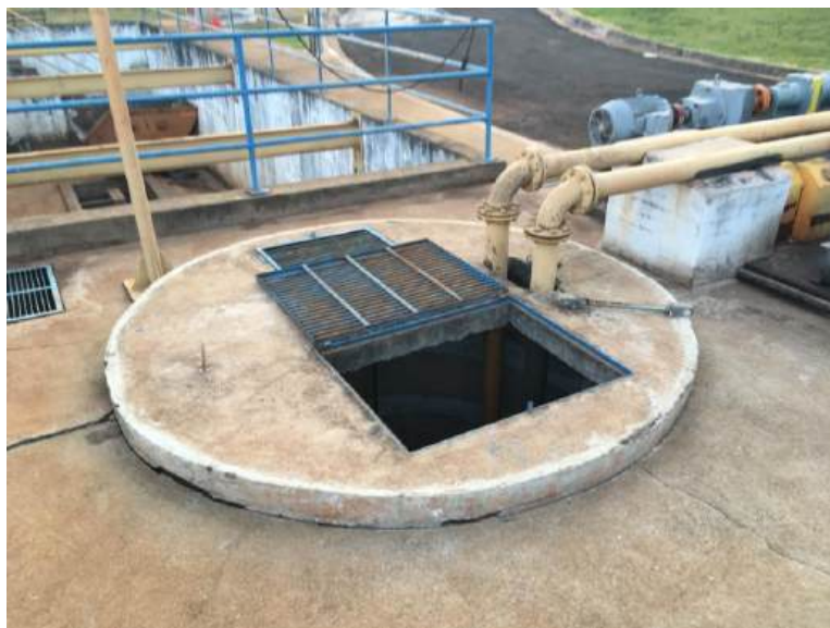
Foto 3.75 – Poço de Sucção da EEE Nosso Teto
