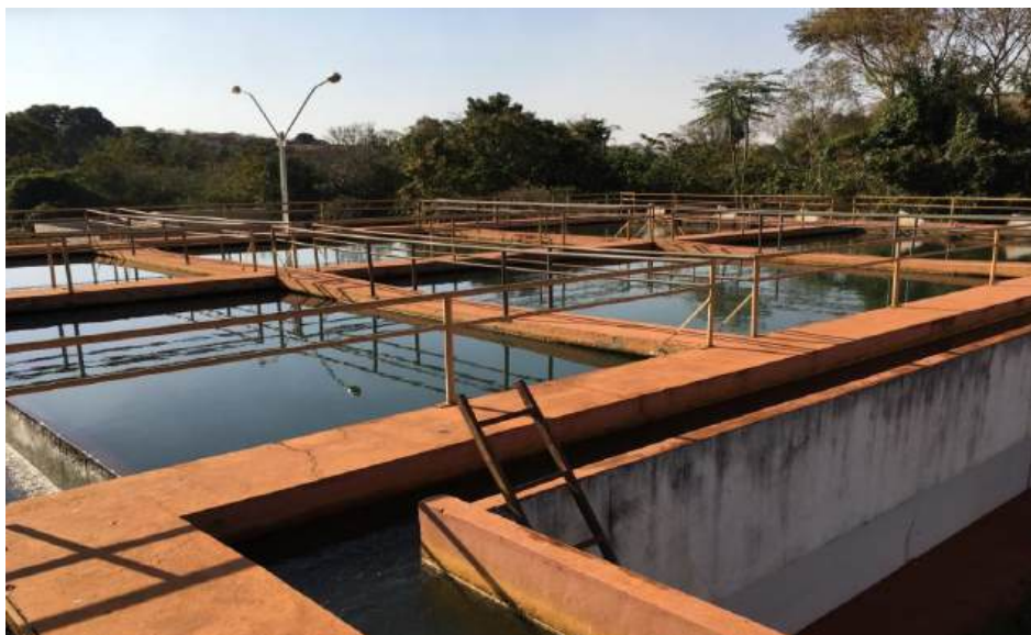
Foto 3.7 – Vista dos Decantadores
