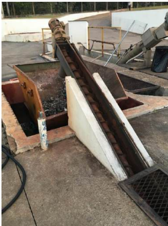
Foto 3.66 – Detalhe da retirada de sólidos da caixa de areia mecanizada da Estação Elevatória
