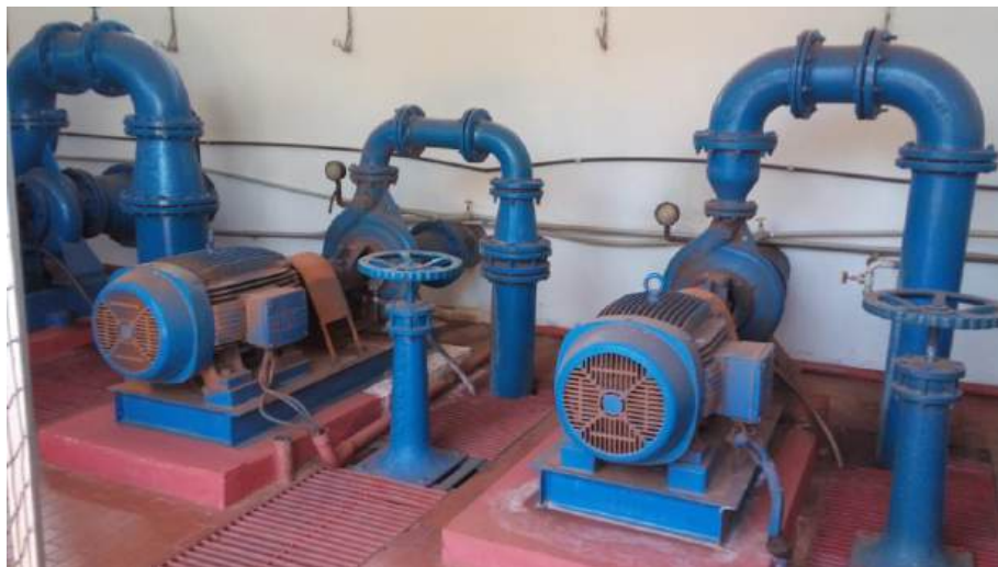
Foto 3.34 – Vista dos conjuntos motobomba que abastecem o Centro de Reservação Guanabara (B-3) e a Praça 10 de Março (B-4)
