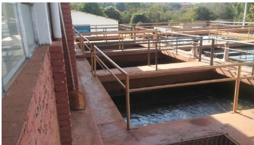
Foto 3.8 – Vista dos Filtros
