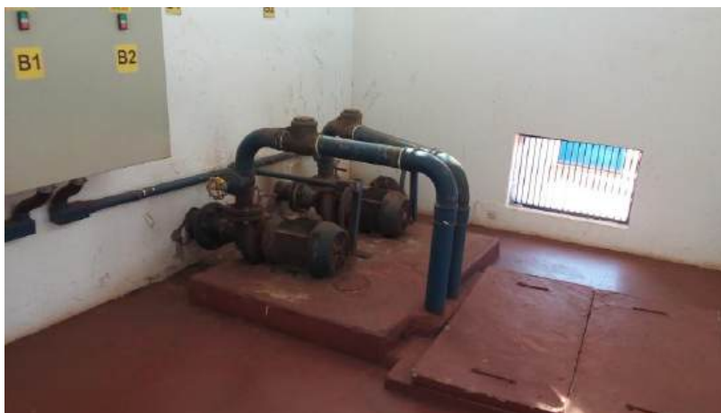
Foto 3.41 – Vista da EEAT localizada dentro da área do CR Estação
