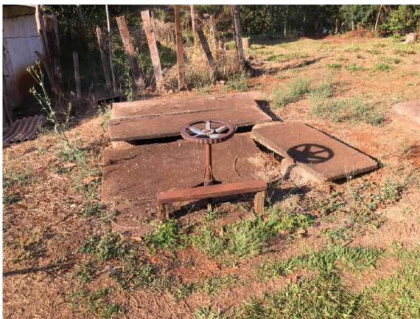
Foto 3.4 – Detalhe do volante da tubulação da captação
