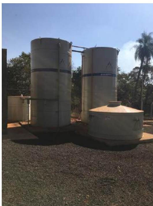
Foto 3.113 – Vista dos reatores da ETE de Capivari da Mata
