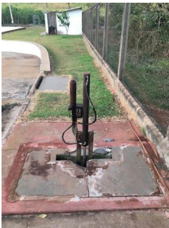
Foto 3.64 – Detalhe do controle de vazão da entrada da EEE Vila São Jorge
