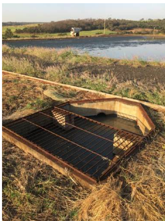
Foto 3.82 – Vista da Caixa de distribuição da entrada da ETE de Ituverava
