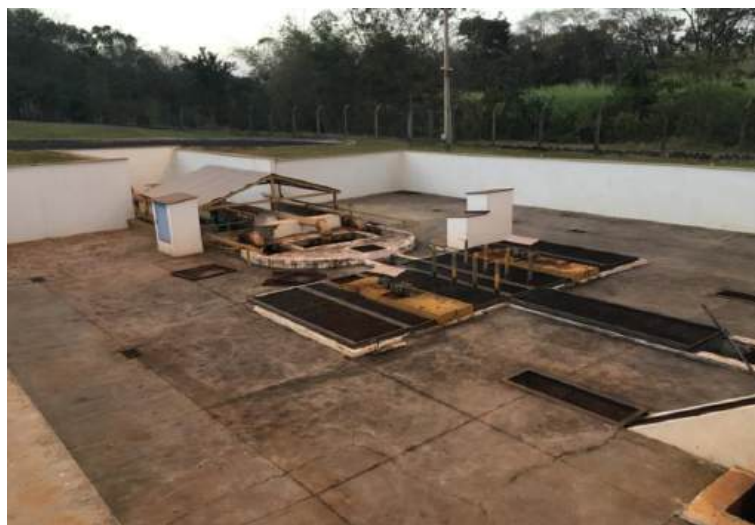
Foto 3.67 – Vista da Caixa de areia mecanizada e do poço de sucção de EEE
