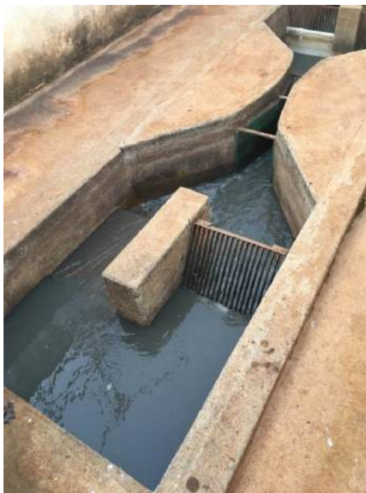
Foto 3.73 – Vista da entrada do efluente bruto na EEE Nosso Teto, do gradeamento e da Calha Parshall
