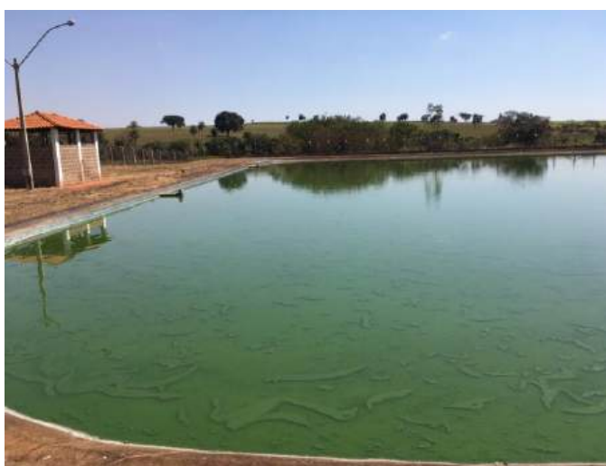
Foto 3.107 – Vista de segunda lagoa e do abrigo do clorador da ETE de São Benedito da Cachoeirinha
