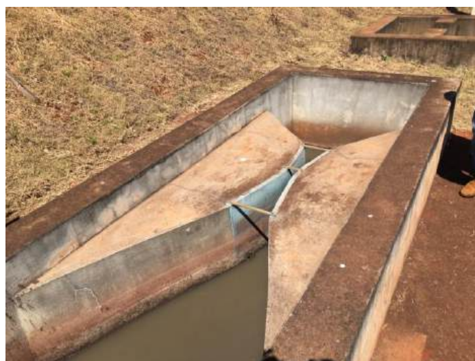
Foto 3.104 – Detalhe da Calha Parshall, ETE do Distrito de São Benedito da Cachoeirinha
