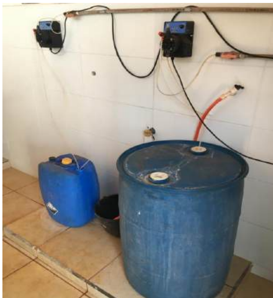
Foto 3.59 – Detalhe dos dosadores do Distrito de Capivari da Mata
