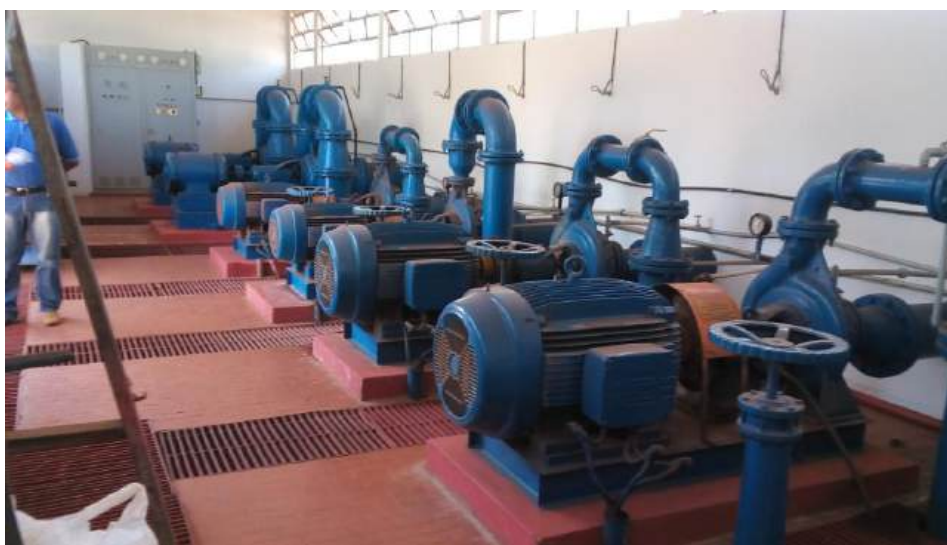
Foto 3.33 – Vista geral dos conjuntos motobomba da EEAT 1
