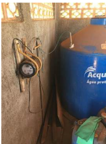
Foto 3.102 – Dosador de cloro para desinfecção do efluente
