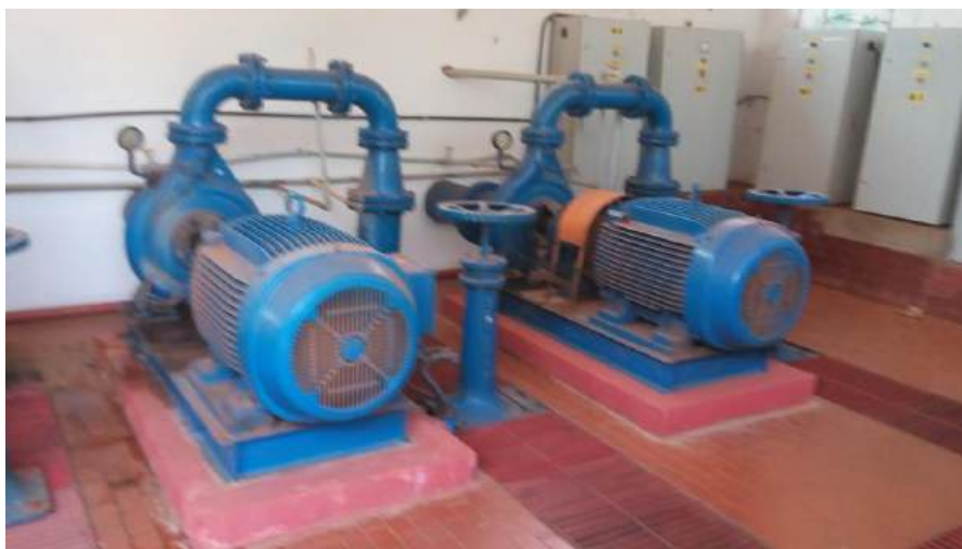
Foto 3.35 – Vista dos conjuntos motobomba que abastecem o CR Estação
