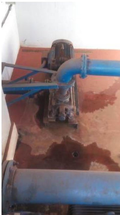
Foto 3.38 – Vista dos conjuntos motobomba que abastecem o CR Estação
