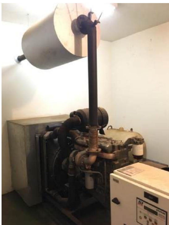
Foto 3.71 – Detalhe do gerador da EEE Vila São Jorge
