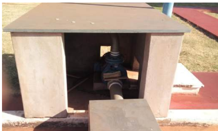
Foto 3.44 – Vista da EEAT localizada dentro da área do reservatório Tropical 2
