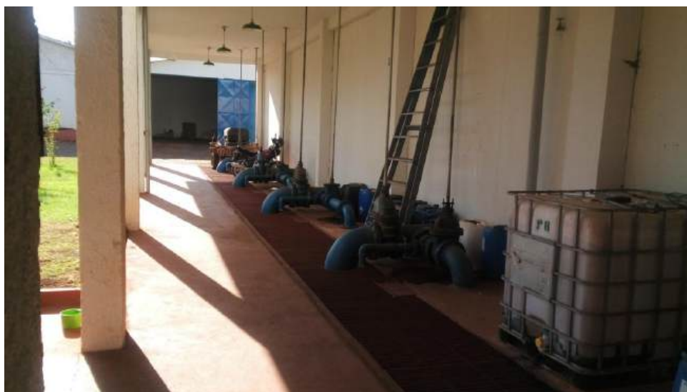
Foto 3.9 – Vista do controle das saídas dos filtros
