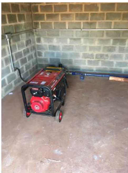
Foto 3.116 – Detalhe do gerador de energia da ETE
