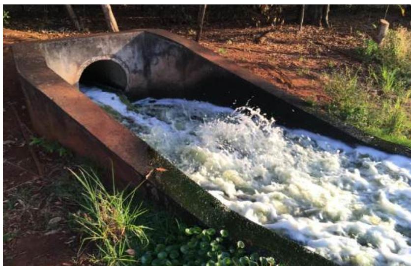
Foto 3.91 – Saída da tubulação do efluente tratado
