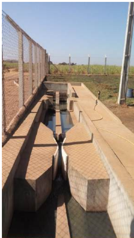
Foto 3.97 – Vista do gradeamento, caixa de areia e Calha Parshall da ETE de Aparecida do Salto
