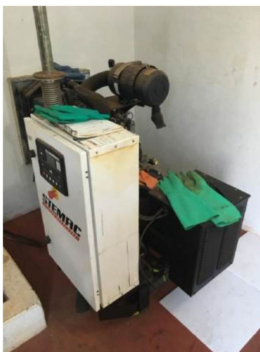
Foto 3.77 – Detalhe do gerador da EEE Nosso Teto
