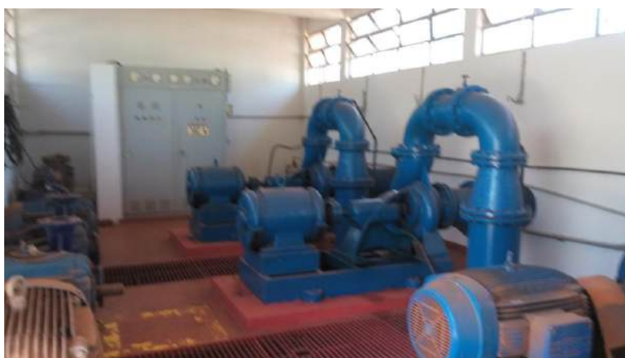
Foto 3.36 – Vista dos conjuntos motobomba que realizam a reversão de fluxo da limpeza dos filtros
